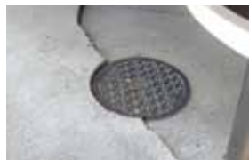
浦安市の液状化による被害
